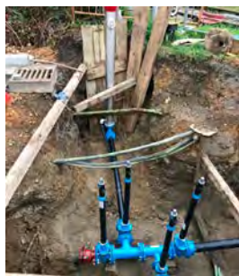
Hydrant mit Schiebergruppe (Quelle: Land Oberösterreich)
