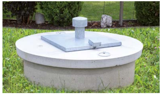
Brunnenvorschacht mit Schachtabdeckung und Entlüftungshut
