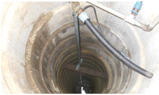
Mangelhafter Schachtbrunnen durch undichte Schachtringe
