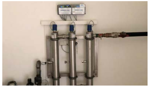
Beispiel einer UV-Desinfektionsanlage
