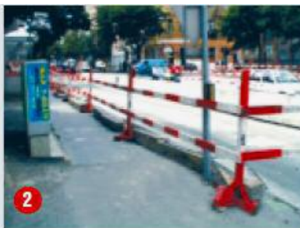
2 Absicherung durch ausreichend befestigte Latten mit Tastleiste in richtiger Höhe.
