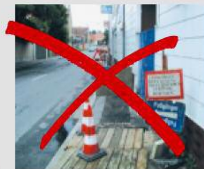
Mangelhafte Absicherung, fehlender Ersatzgehsteig.
