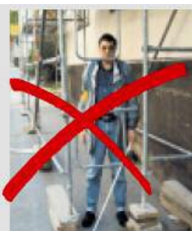
Rundumabsicherung und Tastleiste fehlen.
