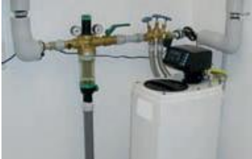
Beispiel einer Wasserenthärtungsanlage (Ionentausch-Verfahren)
