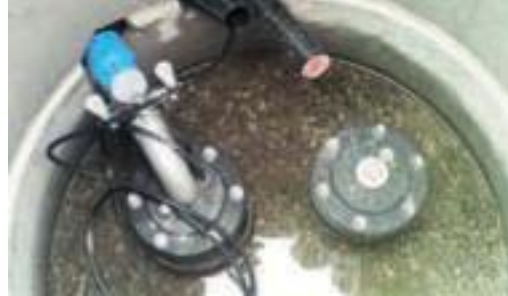
Mangelhafter Vorschacht bei einem Bohrbrunnen
