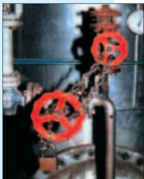
Durch Schloss gesicherte Absperrvorrichtung
