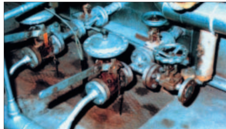
Zwei Absperrvorrichtungen mit dazwischen liegender Druckentlastung; Die Druckentlastung ist offen zu halten. (Kennzeichnung gegen Wiedereinschalten fehlt)
