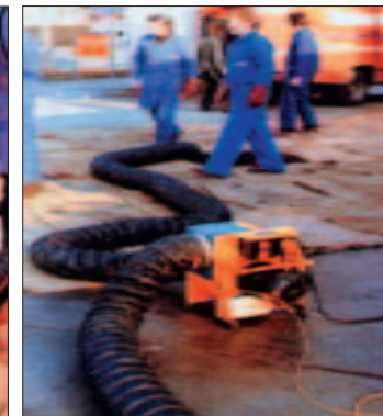
Die abgesaugten Dämpfe sind gefahrlos ins Freie abzuleiten
